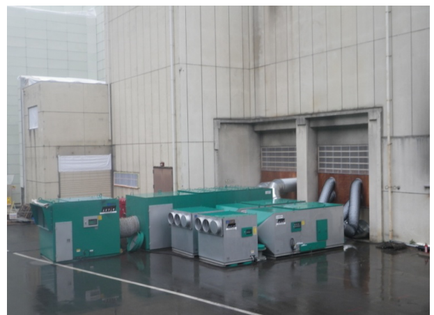
旧工場棟 負圧除じん装置の配置状況
